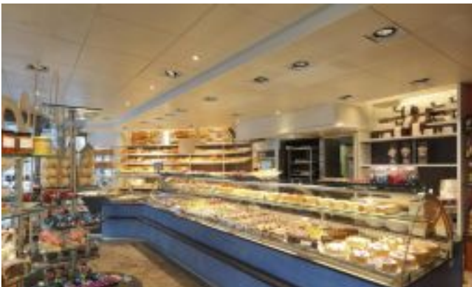
Nachher: LED-Beleuchtung. (Bilder: Frank Schwarzbach)
